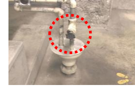
ドレントラップ部
