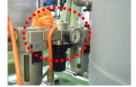
フィルター等接続部
