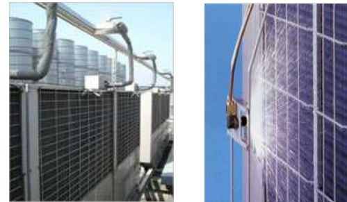
室外機散水装置
