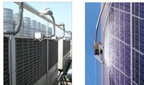
室外機散水装置
