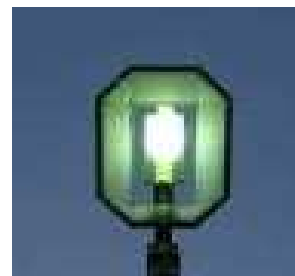
駐車場照明例
