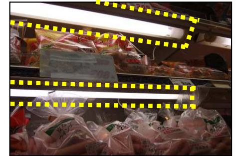
ショーケース棚板照明
