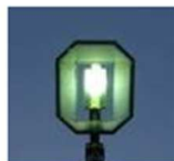
駐車場照明例
