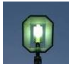
駐車場照明例
