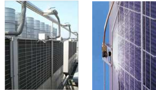
室外機散水装置
