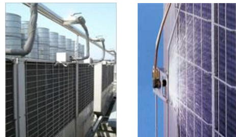
室外機散水装置
